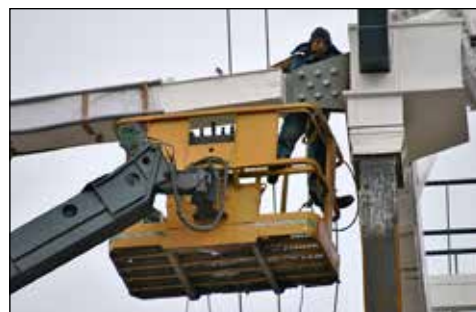
Figura 19. Operario subido sobre las barandillas.
