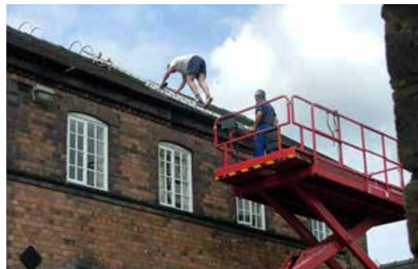
Figura 30. Uso indebido de la PEMP.
